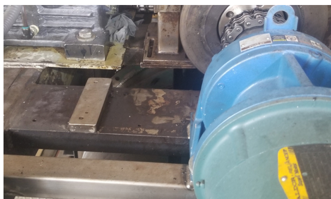
Goteo en reten interno
